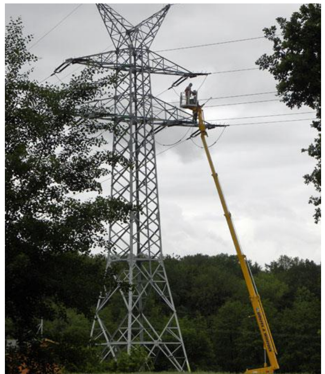
Strommast am Umspannwerk | Foto: Renate Strang
